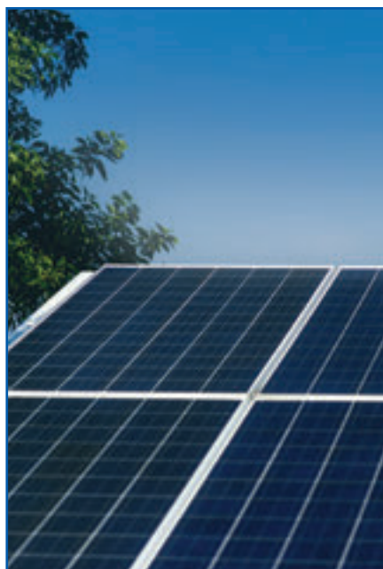
Fotowoltaika to sposób na poprawę efektywności energetycznej w budynkach jednorodzinnych
